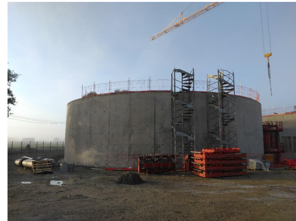
Figure 17 : Réservoir situé à Goven (Photo de la phase de construction en 2022)
